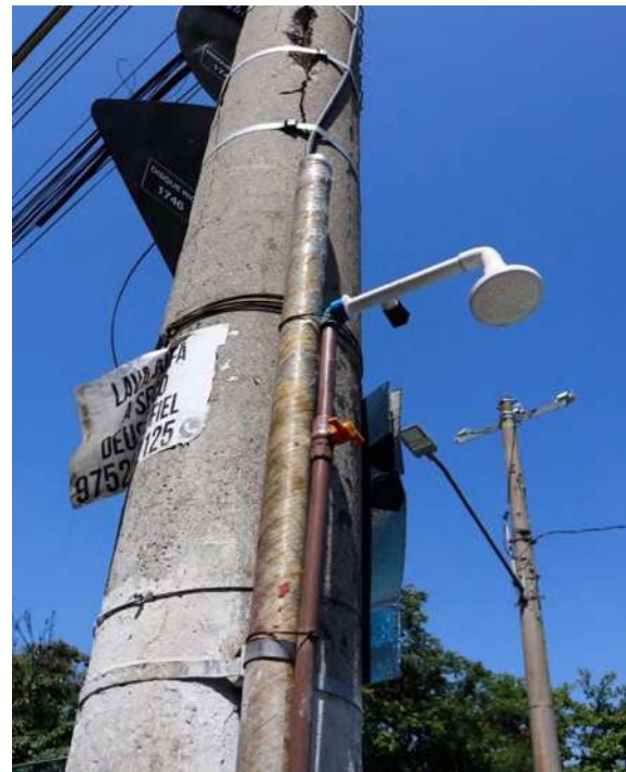
FIG. 220: CHUVEIRO PÚBLICO INSTALADO NO CONJUNTO ESPERANÇA, MARÉ. FONTE: ARTHUR VIANA (2023)
