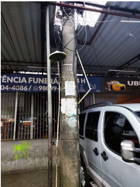
FIG. 219: CHUVEIRO PÚBLICO INSTALADO EM POSTE NA RUA TEIXEIRA DE FREITAS EM NOVA HOLANDA, MARÉ. FONTE: ARTHUR VIANA (2023)
