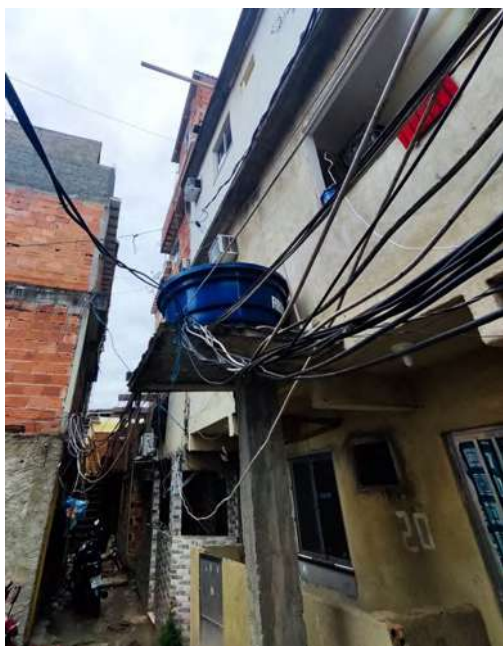
FIG. 223: CAIXA D'ÁGUA E GATOS DE ÁGUA NO MORRO DO TIMBAU. FONTE: AUTORA (2023)
