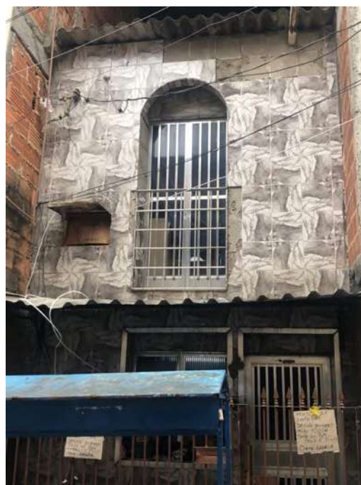
FIG. 134: REMANESCENTE DA ESQUADRIA ORIGINAL EM FORMATO DE ARCO. FONTE: AUTORA (2023)
