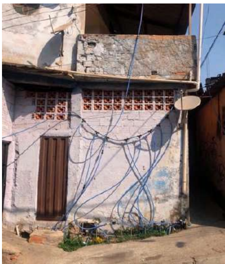
FIG. 9: CONEXÕES EXPOSTAS EM CASA EM FAVELA EM BELO HORIZONTE. FONTE: ALEXANDRE BAXTER (2022)
