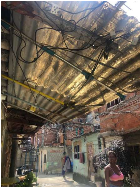
FIG. 217: FIAÇÕES PASSANDO POR COBERTURA IMPROVISADA NO CONJUNTO NOVA MARÉ. FONTE: AUTORA (2023)
