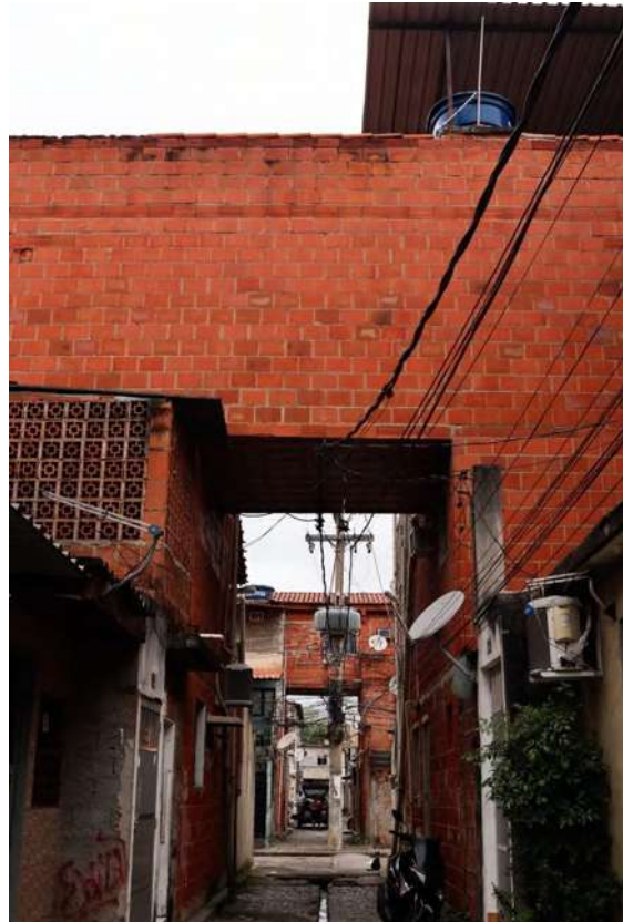
FIG. 163: DETALHE DAS LAJOTAS CERÂMICAS NÃO REBOCADAS E DA JUSTAPOSIÇÃO DE UNIDADES HABITACIONAIS NO CONJUNTO BENTO RIBEIRO DANTAS. FONTE: ARTHUR VIANA (2023)
