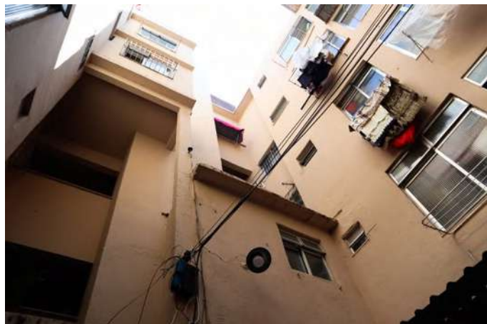
FIG. 152: ACRÉSCIMOS NOS BLOCOS RESIDENCIAIS DO CONJUNTO ESPERANÇA. FONTE: ARTHUR VIANA (2023)
