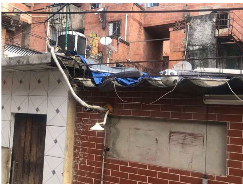
FIG. 221: GAMBIARRAS EM CASA NO CONJUNTO NOVA MARÉ. FONTE: AUTORA (2023)
